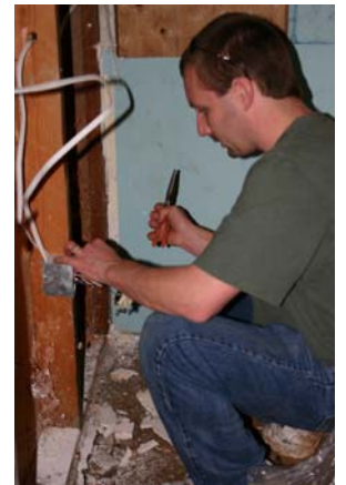
Ron wiring outlets at Casa de Niños in Sinaloa, Mexico.
